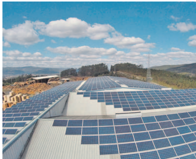
Las que apuesten por la instalación de paneles pueden amortizar el gasto en 5 o 6 años.
