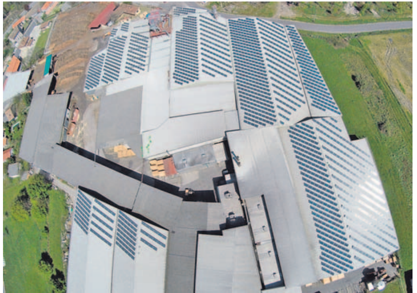
Imagen tomada con un dron de la instalación fotovoltaica récord impulsada en Ourense.
